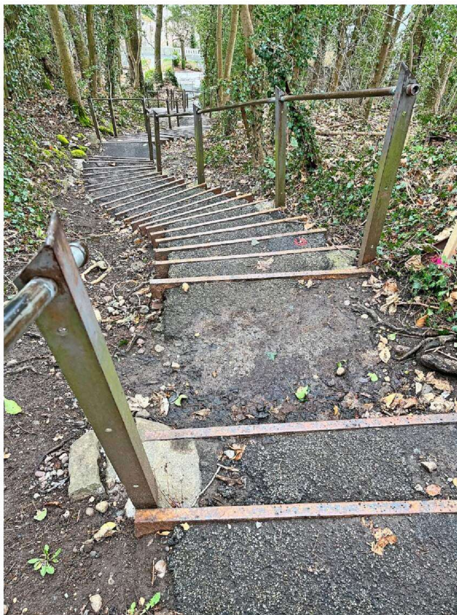
Die Treppe hoch vom und zum Aussichtspunkt Jakobshübeli oberhalb von Thun ist in einem schlechten Zustand und soll nun saniert werden. Doch zu welchem Preis? Foto: Michael Gurtner
