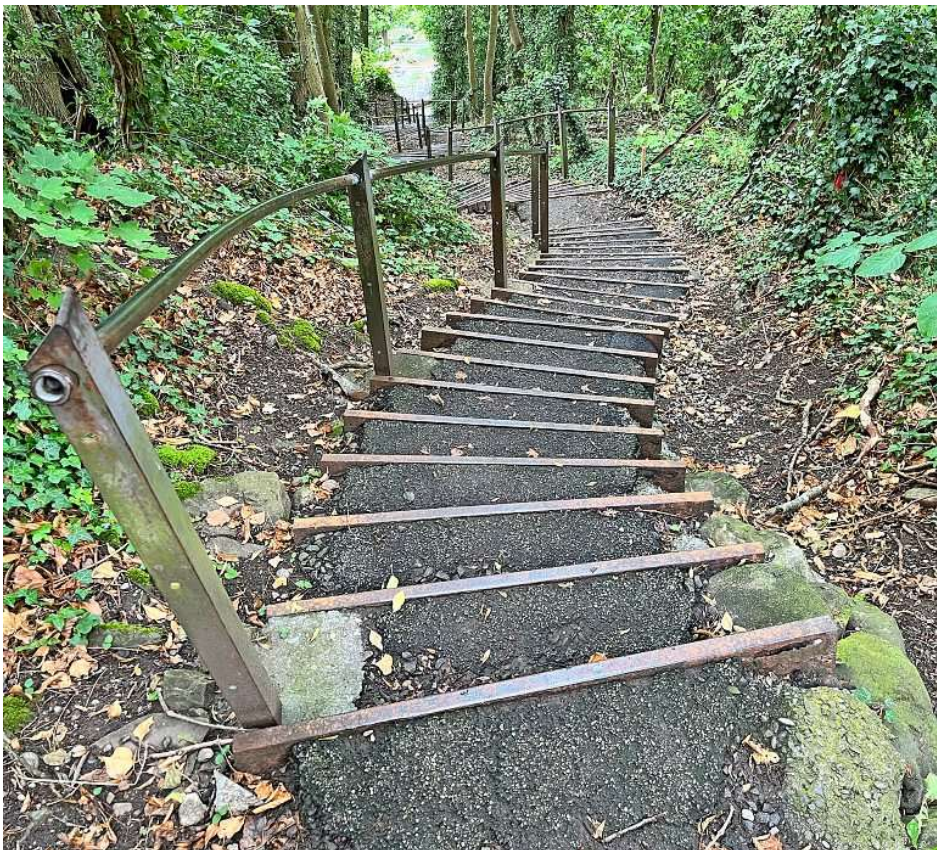
Die Treppe zum Aussichtspunkt Jakobshübeli oberhalb von Thun ist in schlechtem Zustand und muss saniert werden. Fotos: Michael Gurtner
