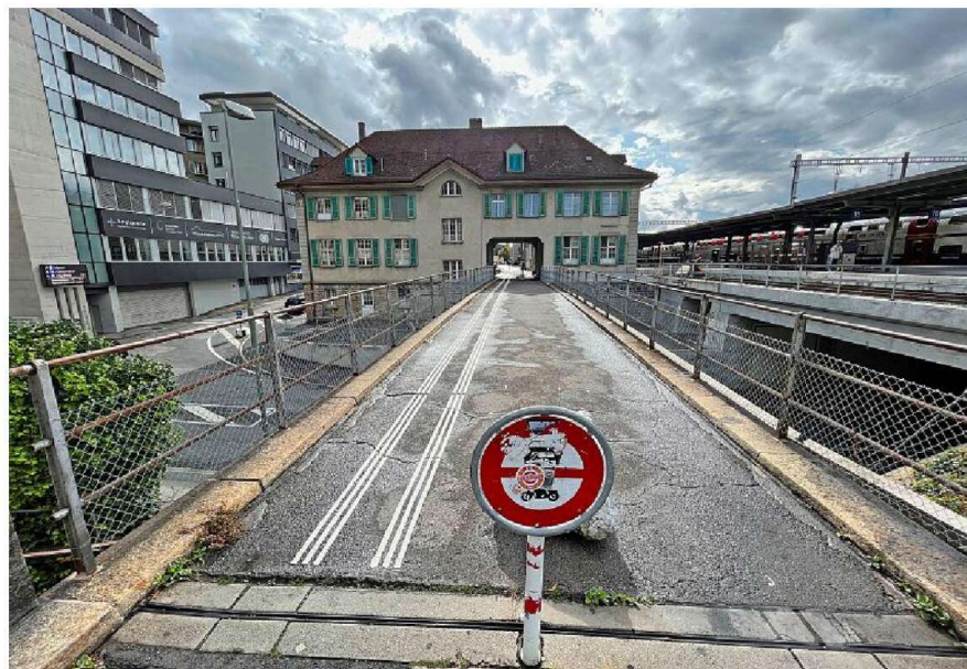
Das Milchbrüggli beim Bahnhof Thun muss abgerissen und neu gebaut werden. Foto: Michael Gurtner
