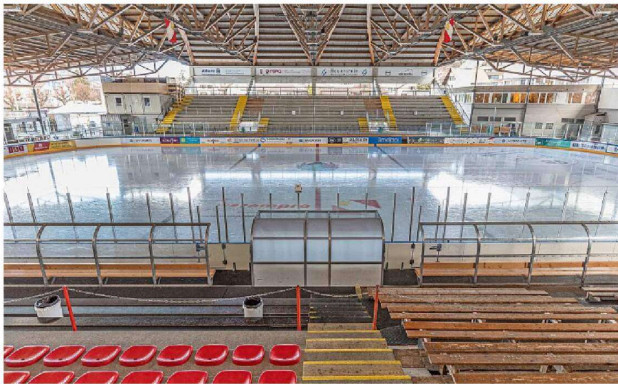
Die geplante Gesamtsanierung der in die Jahre gekommenen Tribüne der Kunsteisbahn Grabengut verzögert sich weiter. Foto: Christoph Gerber
